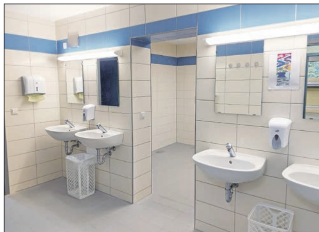
Den Sportlern stehen nun endlich moderne Sanitäranlagen zur Verfügung. Foto: Uwe Werner
